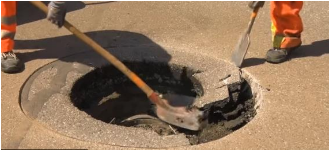
5. Выставление уровня отремонтированного люка, чтобы понять на какую высоту необходимо поднять горловину.
